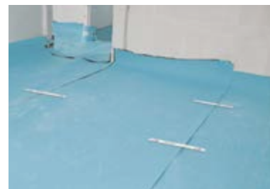
(3) Remonter de \pm 15 cm contre les murs avant de réaliser la chape
